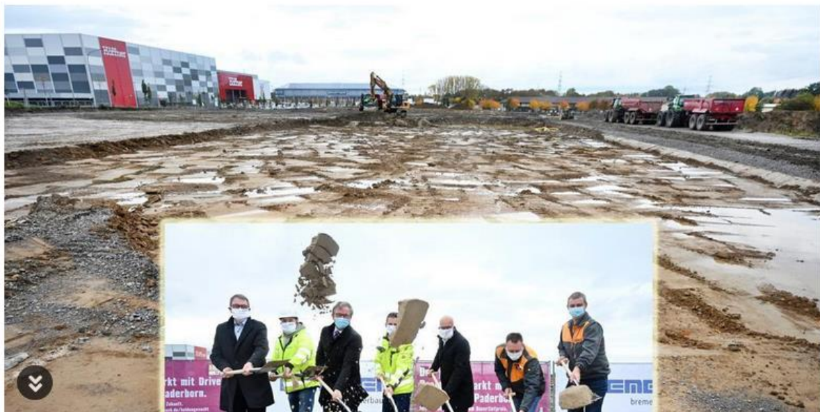
Michael Dufhues, Bauleiter Thomas Fedrowitz, Michael Dreier, Projektleiter Thomas Behnisch, Bremer-Vorstand Matthias Molter sowie Hornbach-Marktmanager Jens Northemann und Gebietsleiter Enrico Gaffrey (von links) greifen zu den Spaten. Fotos: Oliver Schwabe
